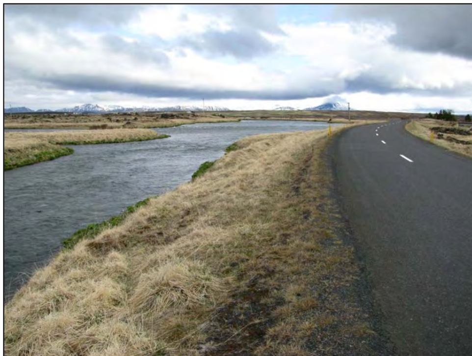
Mynd 6. Hættulegur vegkantur á bökkum Laxár sunnan við Helluvaðsá.
